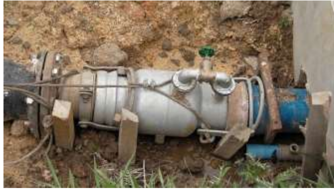
Figura 241: Exemplo de instalação inadequada da ancoragem de uma válvula de retorno após a motobomba.
