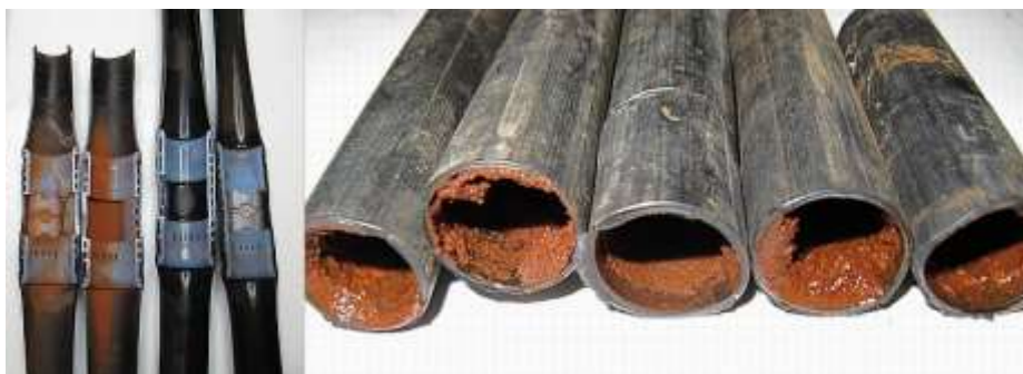
Figura 120: Detalhe de gotejadores e tubulações com sedimentos e óxido de ferro.
