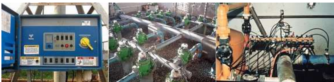
Figura 15: Exemplo de unidades de automação e controle: a esquerda, caixa de controle de pivô central, no centro, conjunto de válvulas volumétricas e a direita sistema de controle de válvulas hidráulicas.
