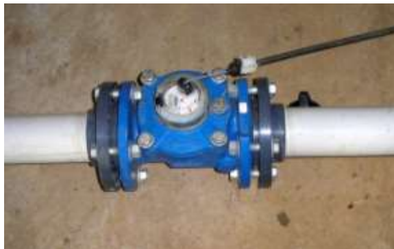
Figura 124: Detalhe de uma válvula volumétrica instalada na tubulação de um cabeçal de controle.
