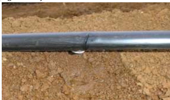
Figura 152: Detalhe de um gotejador conectado à parte interna da tubulação (Fonte: ANTUNES, 2006).
