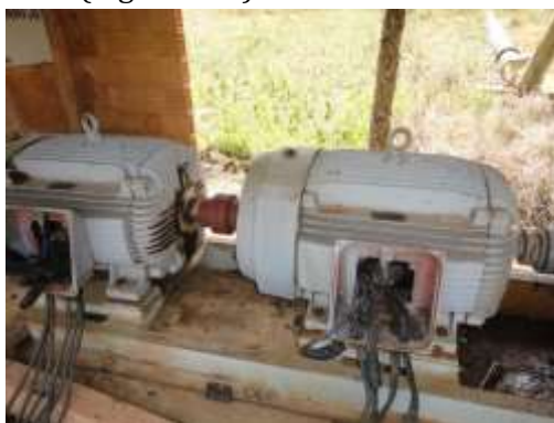
Figura 268: Motores elétricos com fiação expostas em uma motobomba.
