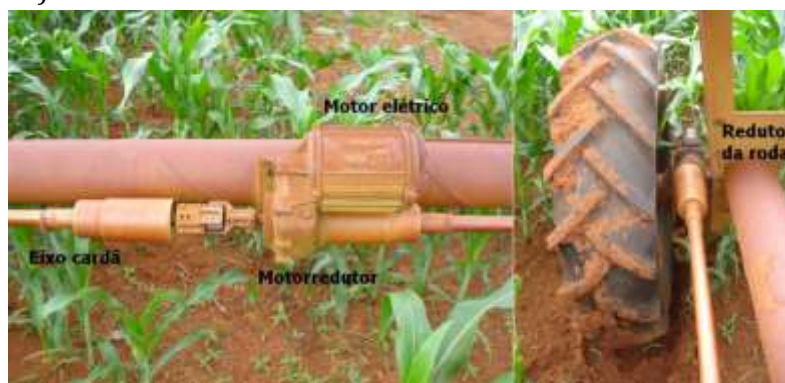
Figura 85: Detalhe do conjunto de motorredução da torre móvel (esquerda) com detalhes da transmissão de movimento por eixo cardã para o redutor de roda (direita).
