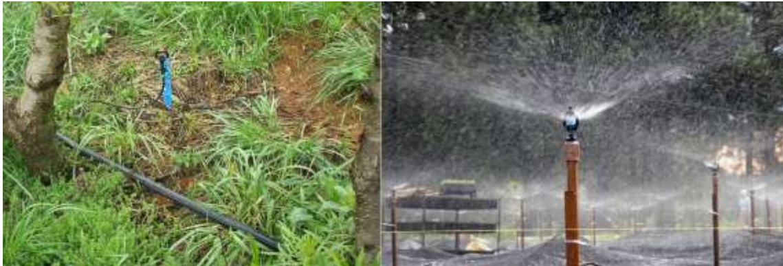
Figura 163: Exemplos de microaspersores instalados na posição em pé (Fonte: ANTUNES, 2006).
