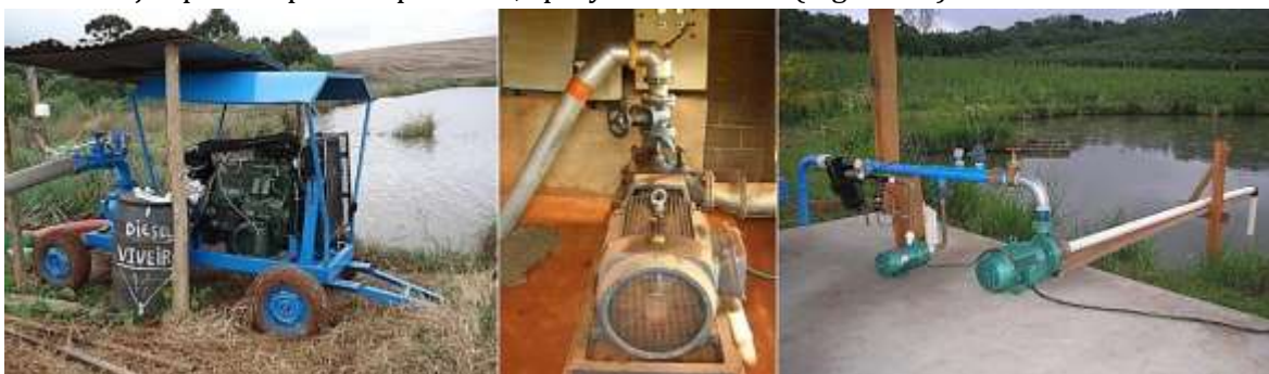
Figura 12: Exemplos de estações de bombeamento utilizadas em sistemas de irrigação.
