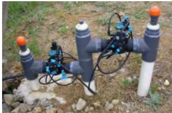
Figura 132: Sistema de controle de pressão e de operação instalados em cavaletes de setores do sistema de irrigação localizada (Fonte: ANTUNES, 2006).
