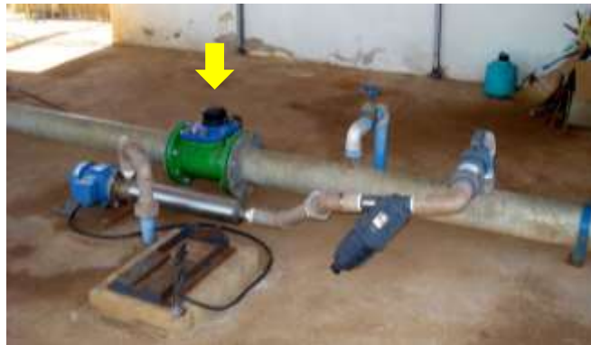
Figura 246: Exemplo de válvula volumétrica instalada em um sistema de irrigação localizada.
