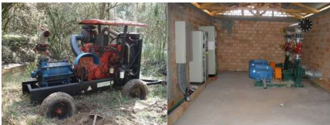
Figura 56: Exemplos de sistemas motobombas: móvel a óleo diesel (esquerda) e fixa e elétrica (direita).
