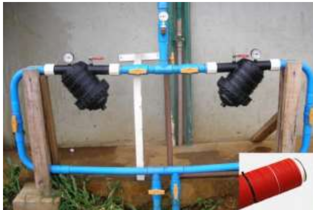
Figura 127: Instalação de filtros de disco com manômetros e detalhe do elemento filtrante.
