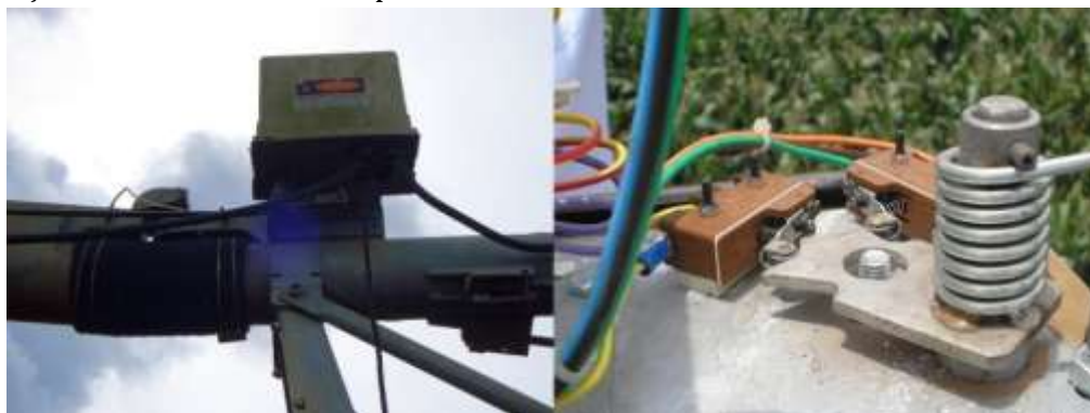
Figura 94: Vista da caixa de controle das torres móveis e dos micro interruptores.
