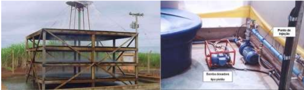
Figura 156: Tratamentos para fatores químicos de entupimento: aerador (esquerda) e bomba de pistão injetora de cloro (direita).
