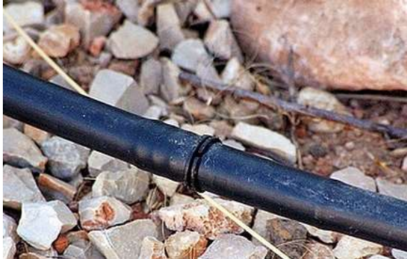
Figura 153: Detalhe de um gotejador instalado de forma interligado entre dois trechos de uma linha lateral.
