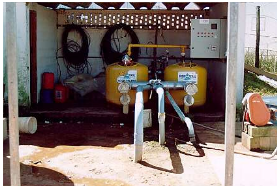
Figura 222: Sistema de filtros de areia utilizados em irrigação de estufas.
