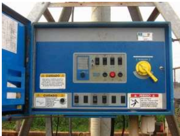
Figura 81: Modelo de caixa de controle instalada na torre central de um pivô.
