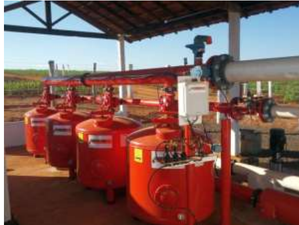
Figura 181: Instalações de um cabeçal de controle para irrigação por gotejamento subsuperficial em cana de açúcar.
