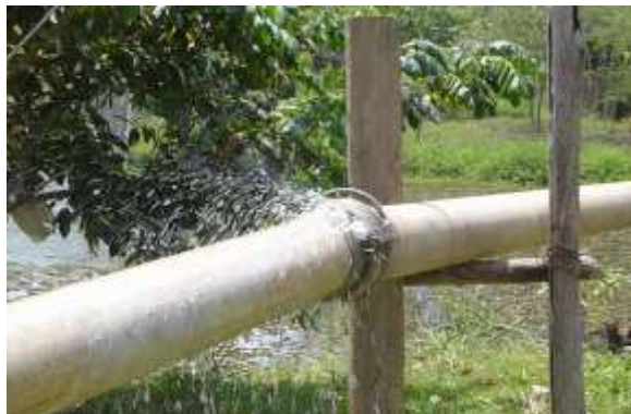
Figura 245: Vazamento em tubos metálicos de irrigação.
