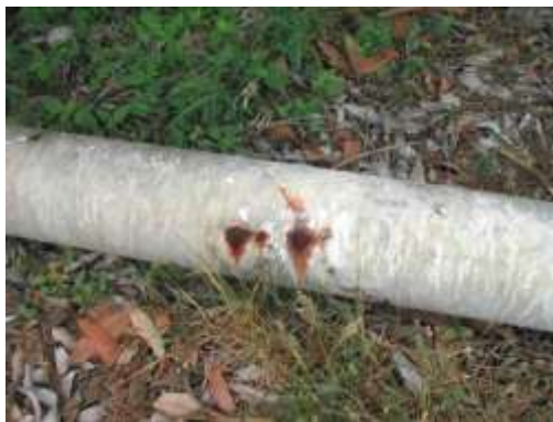
Figura 265: Exemplo de tubulação com corrosão da parede devido à qualidade de água da irrigação.
